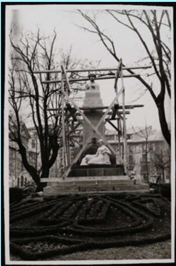
Monumento a Pablo Sarasate en 1964 preparado con andamios para ser desmontado. Autor desconocido. Archivo Municipal de Pamplona (Colección Arazuri) – UO110454
