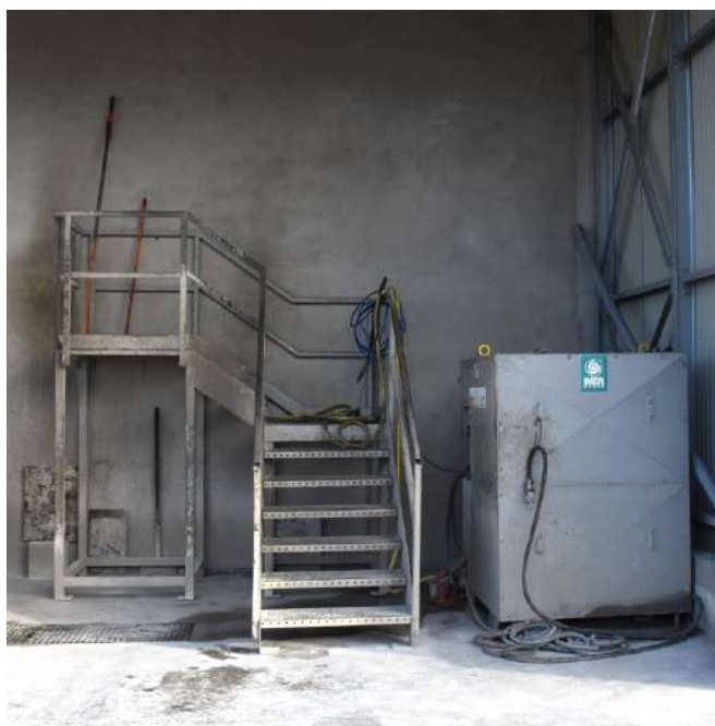
Solution de traitement des eaux - Site de Préfa Béton 72
