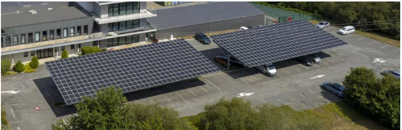
Ombrières photovoltaïques - Le Batimans
