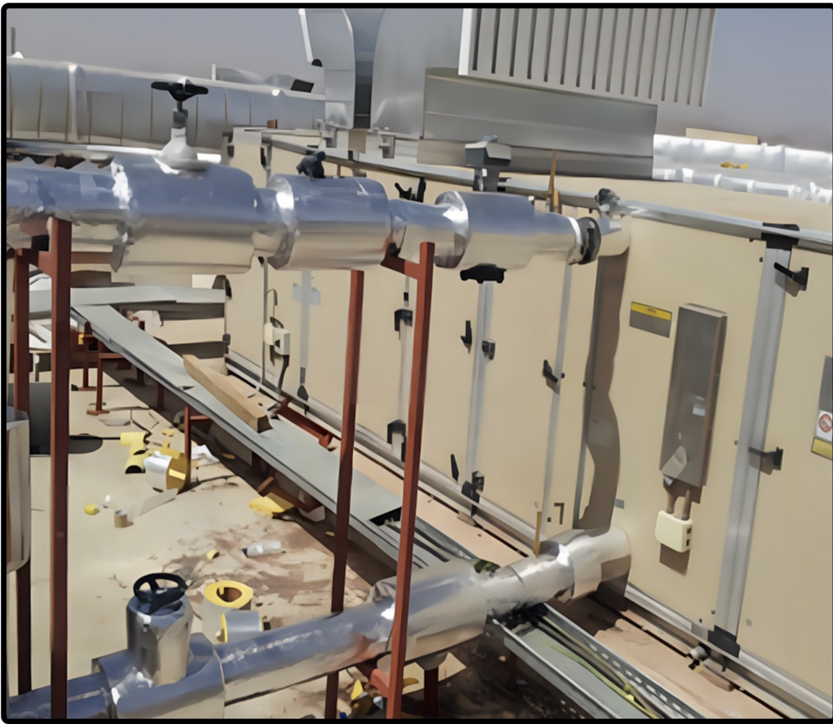
AIR HANDLING UNIT ( AHU)
