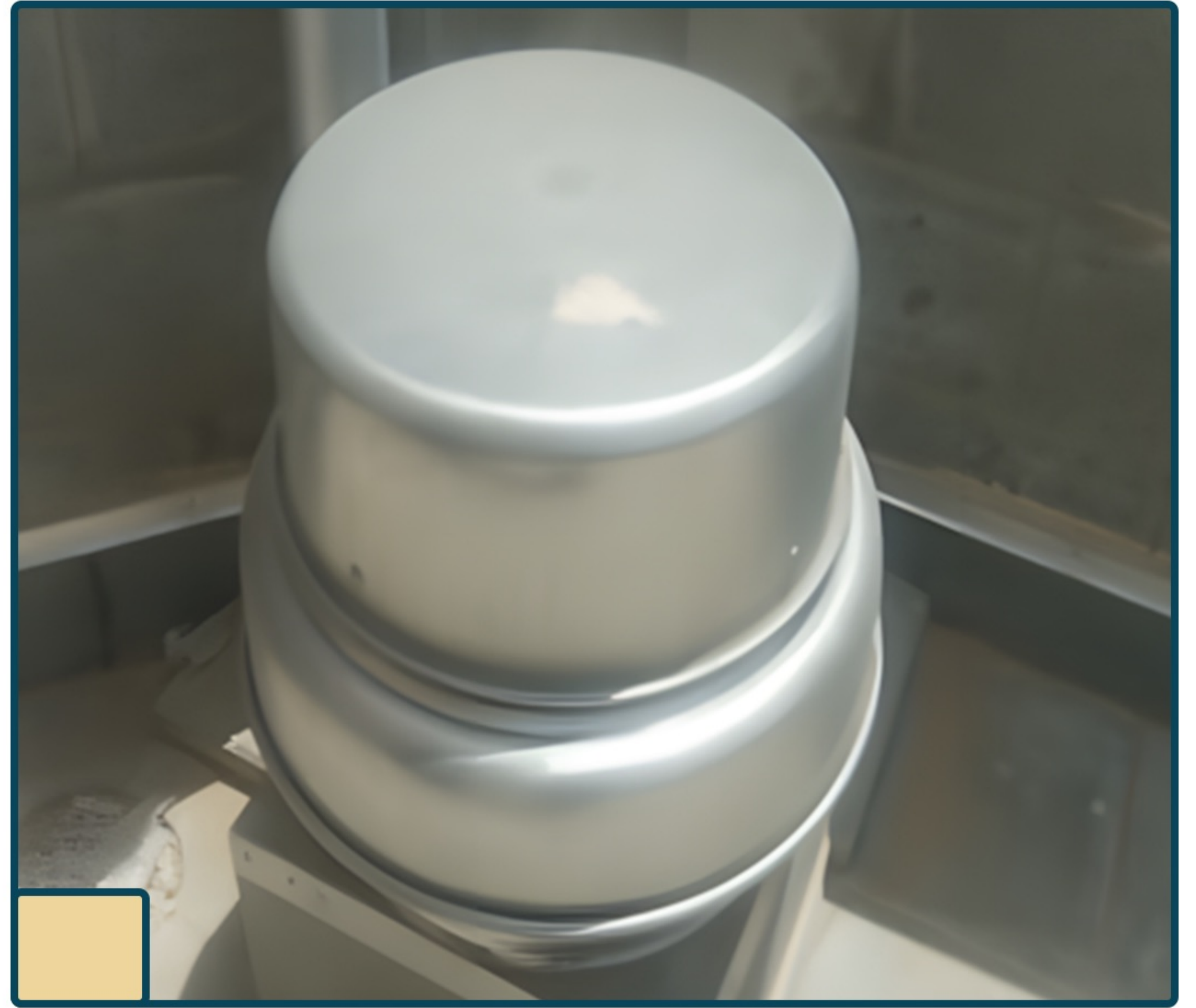
Roof top fan
