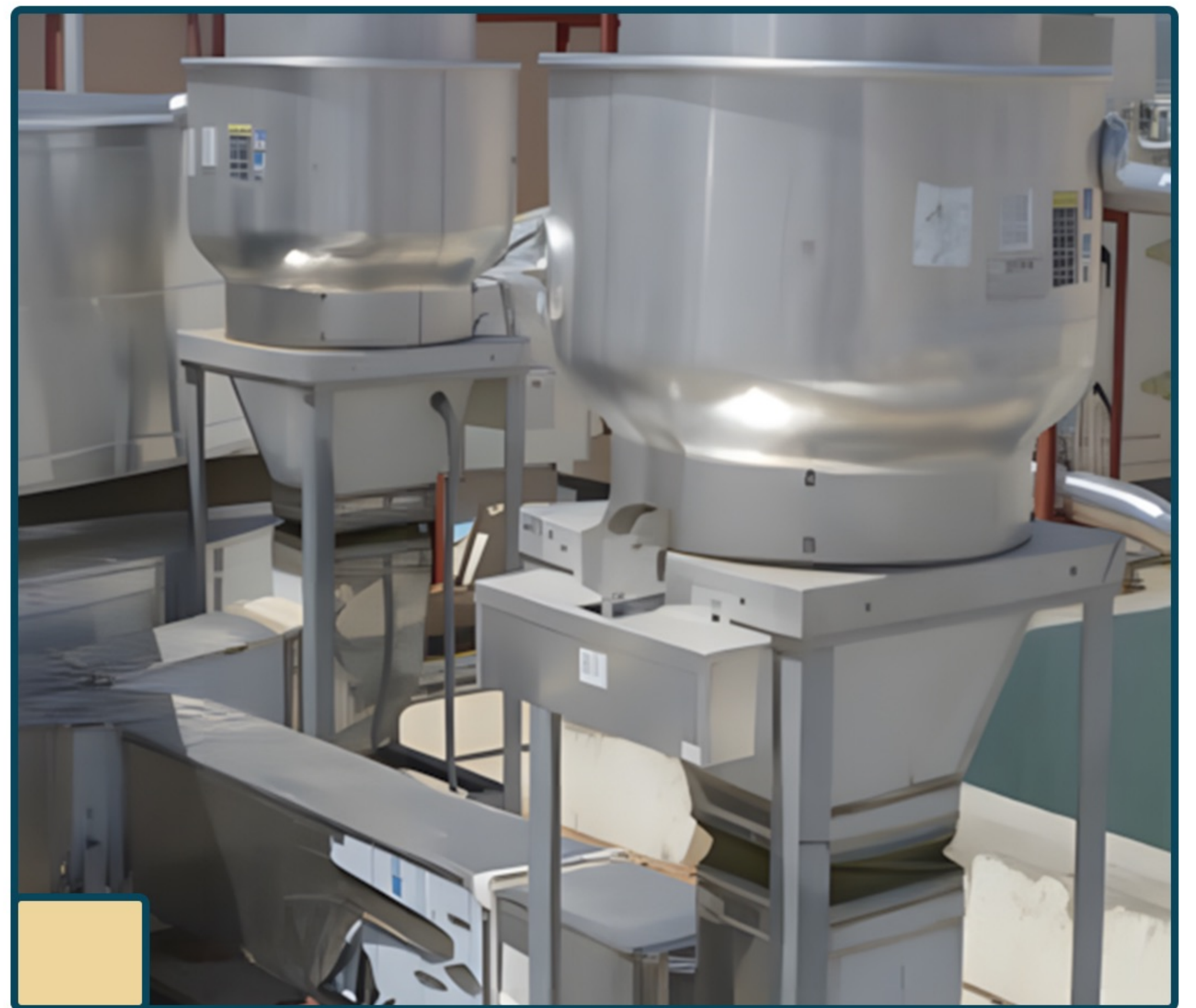
Roof top exhaust fan
