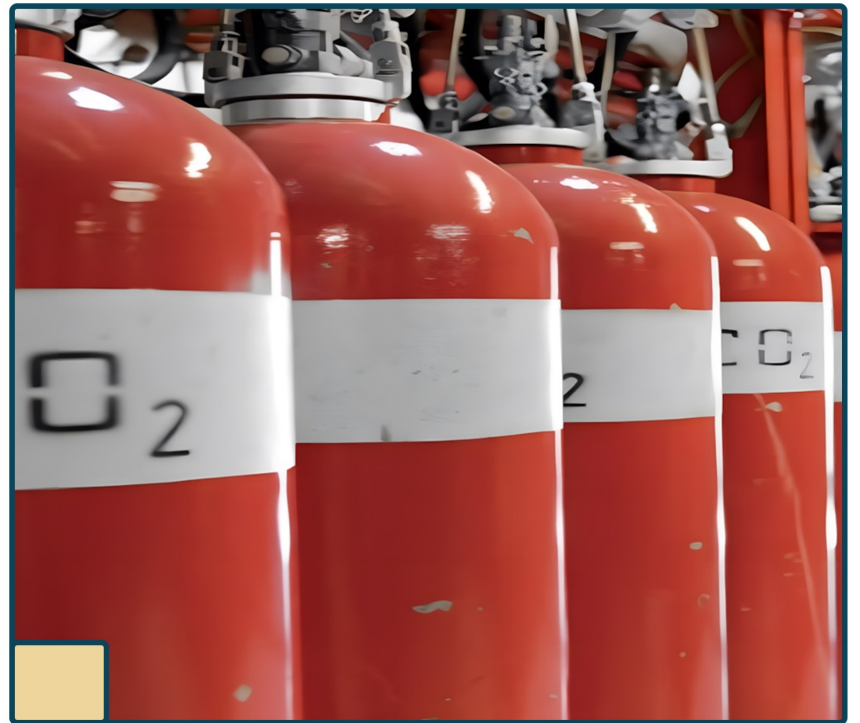
Gas Pipe CO2 System
